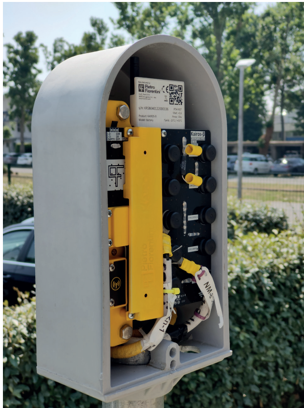
Abbildung 4 Kairos, vor Ort installiert
